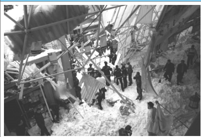
삼척중앙시장 아케이드 붕괴
