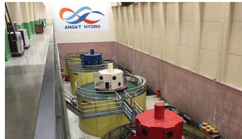
필리핀 앙가(Angat)댐 발전설비 (사진제공 : 한국수자원공사)
