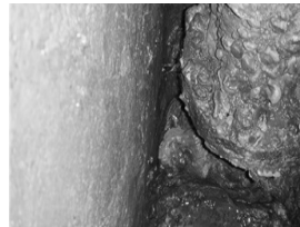
▼ 부대 내 물탱크 노후화
