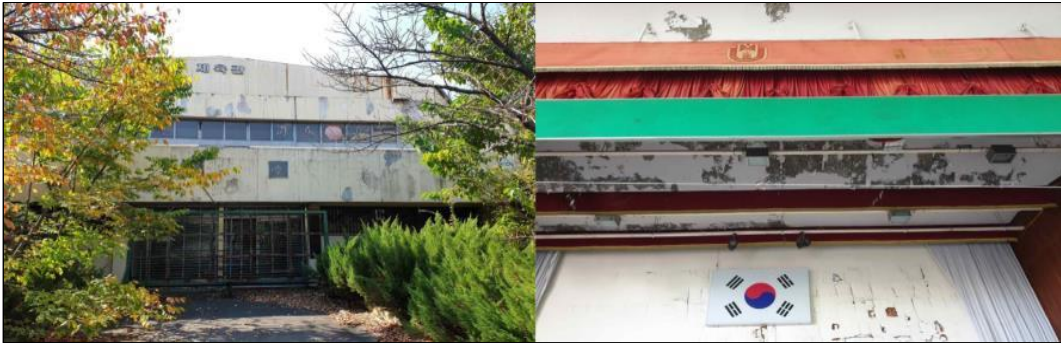
[그림 Ⅲ-4] 13동 외부 오염 및 내부 균열
