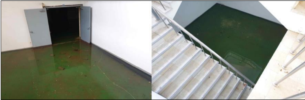
[그림 III-9] 17동(제1공학관) 지하층 침수 현장
