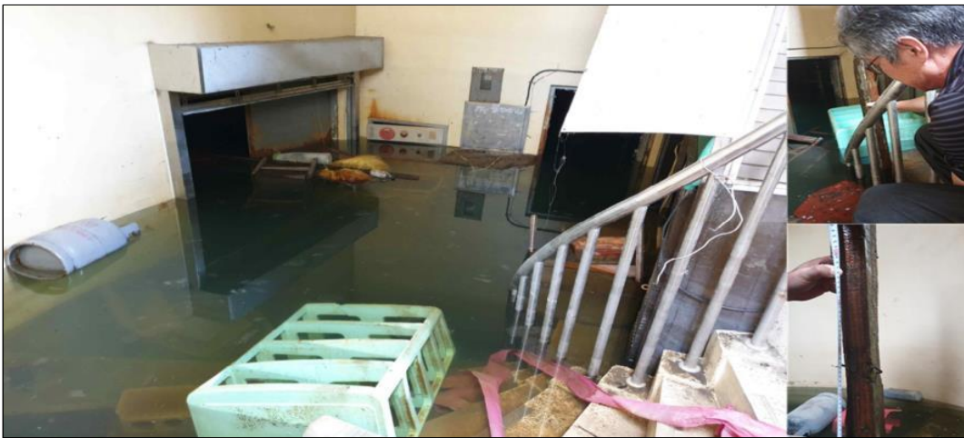
[그림 III-6] 1동(제2공학관) 지하층 침수 현장
