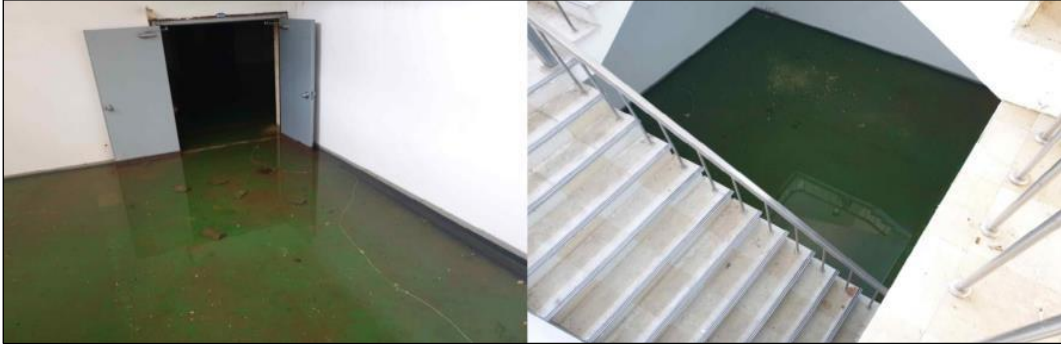
[그림 5] 17동(제1공학관) 지하층 침수 현장
