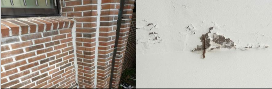
[그림 III-8] 17동(제1공학관) 외부 및 내부 균열
