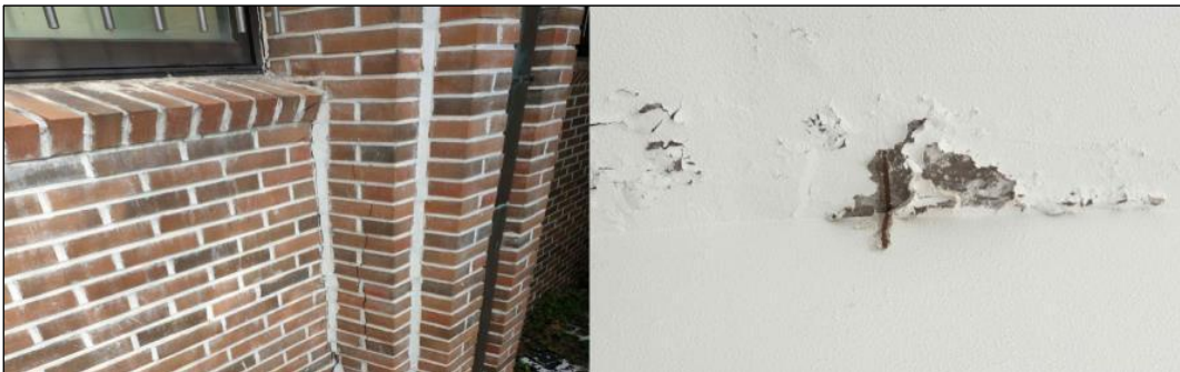
[그림 4] 17동(제1공학관) 외부 및 내부 균열
