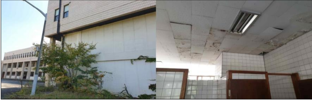
[그림 Ⅲ-3] 6동 외부 균열 및 내부 오염
