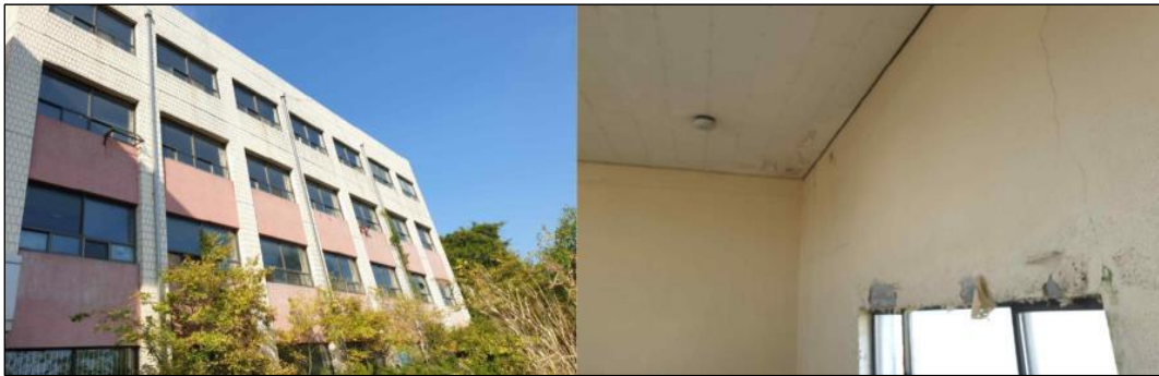
[그림 Ⅲ-1] 2동 외부 상태 및 내부 균열
