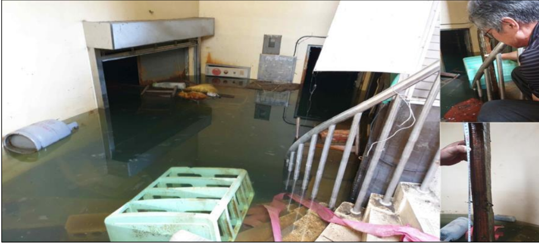
[그림 2] 1동(제2공학관) 지하층 침수 현장
