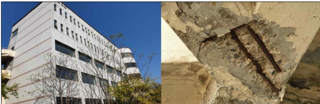
[그림 Ⅲ-2] 5동 외부 상태 및 통로 균열
