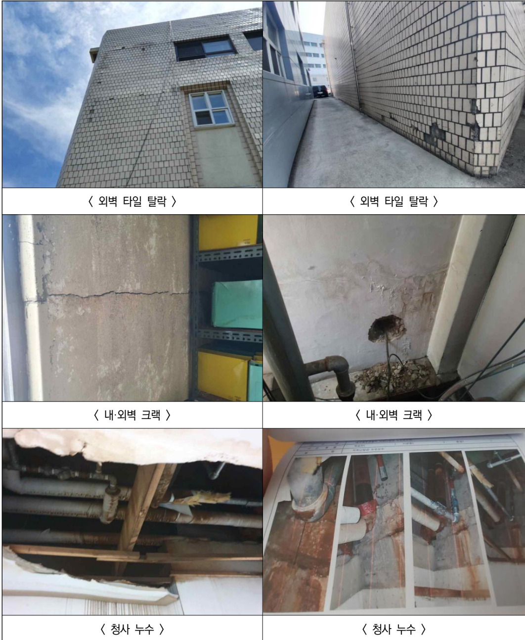
[그림 Ⅲ-7] 본관동 균열 및 타일 탈락
