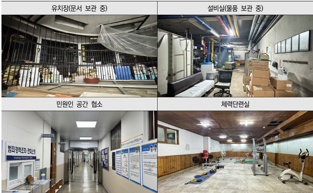
[그림 Ⅲ-2] 건물 내부 협소 현황
