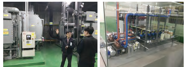
롯데마트 부산 광복점에 도입된 해수열 냉난방 시스템과 모형 사진
