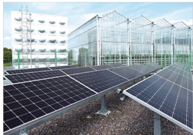
에너지자립형 스마트팜 설비 전경
